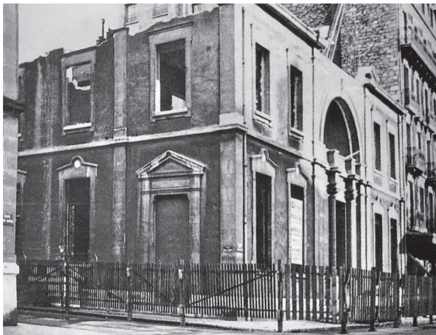
↑ Figure 1. Le temple maçonnique à l'angle de la rue Billerey et du cours Jean-Jaurès en voie de démolition le 15 novembre 1940.
